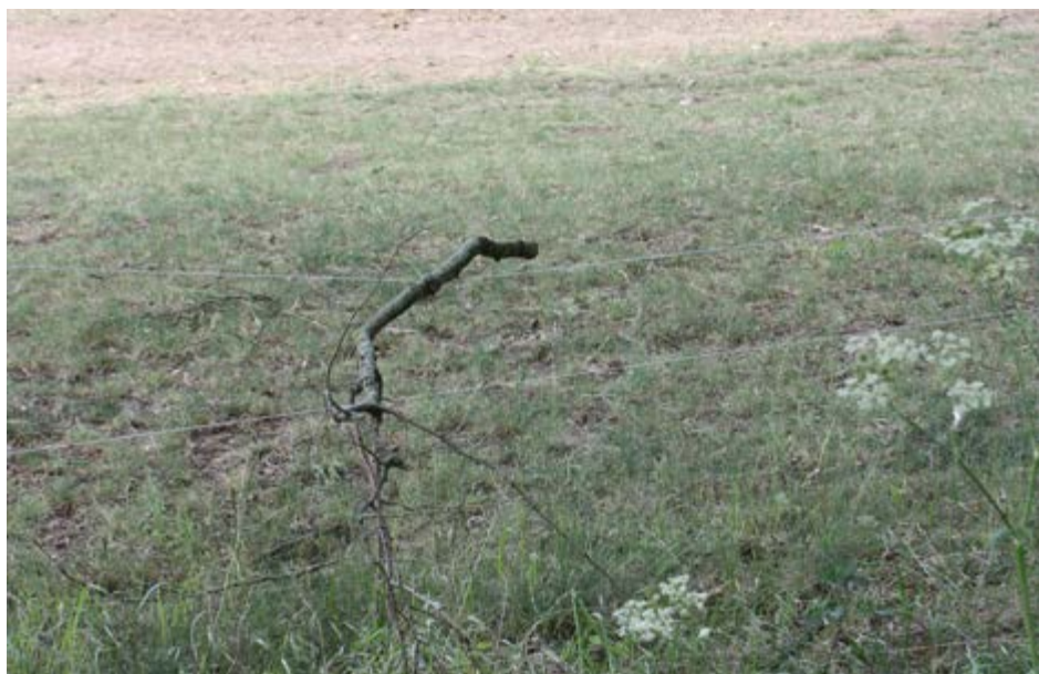
Ein Ast auf den stromführenden Leitern ist eine Schwachstelle im System.
