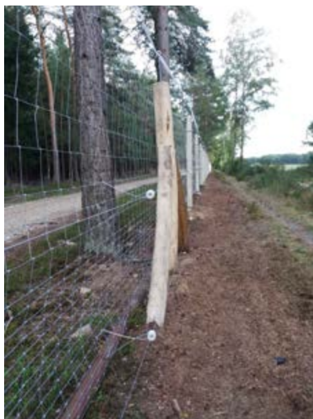
180 Zentimeter Knotengitterzaun für im Gehege gehaltenes Wild mit drei elektrifizierten Drähten in 20-70-170 Zentimeter vom Boden (gegen Untergraben/Unterkriechen sowie Hoch- oder Überklettern). Über dem Zaun ist von innen eine Breitbandlitze gegen Überspringen von Rotwild gespannt.
