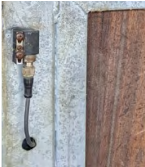
Führanlage mit Kontaktschalter
