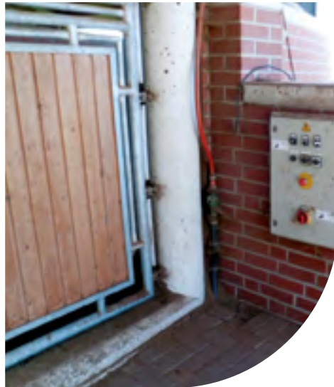
Steuerungseinrichtung in unmittelbarer Nähe zur Führanlage
